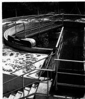
Une station d'épuration.
